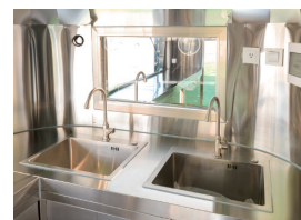
●自動給水ポンプセット2つ
